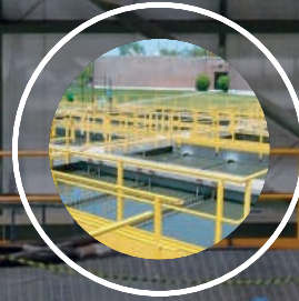
10- Pasarelas, Barandas, Pisos, Piping
