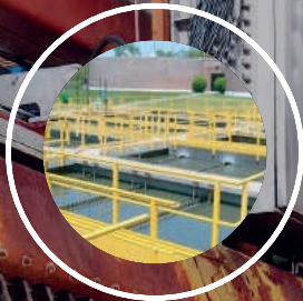
10- Pasarelas, Barandas, Pisos, Piping
